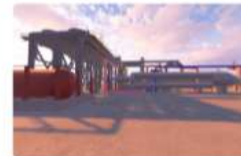
Centrale geotermica a ciclo Binario
